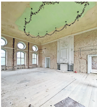
Blick in einen der Schloss-Räume, die denen sehr viel saniert werden muss.
